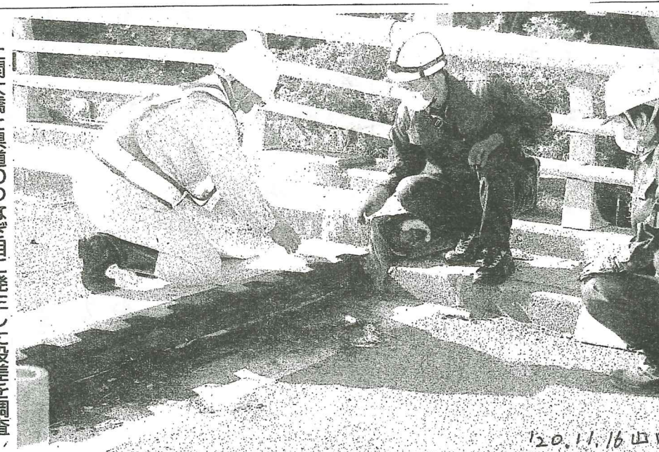
突然はね上がった上関大橋。(壱津側)
